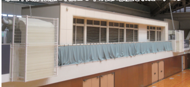
市立中央体育館に平成 25 年の夏に設置されたエアコン
